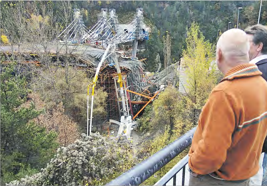
L'esfondrament del viaducte dels Dos Valires, el 7 de novembre.
