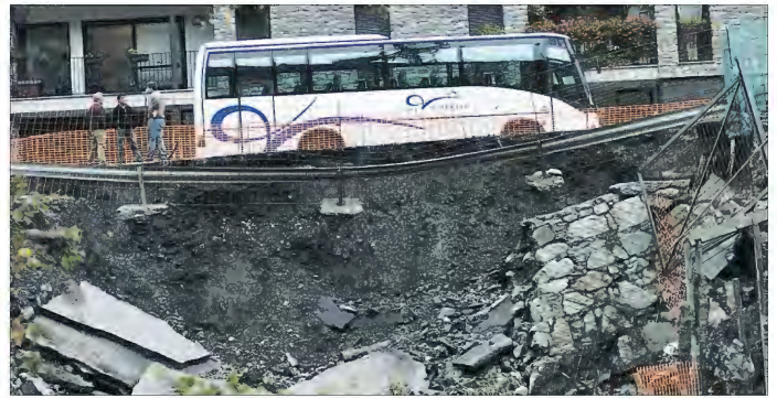
Esllavissada a la CG-3 per unes obres a la Cortinada.
