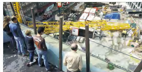
Una grua cau a l'obra del Consell.
