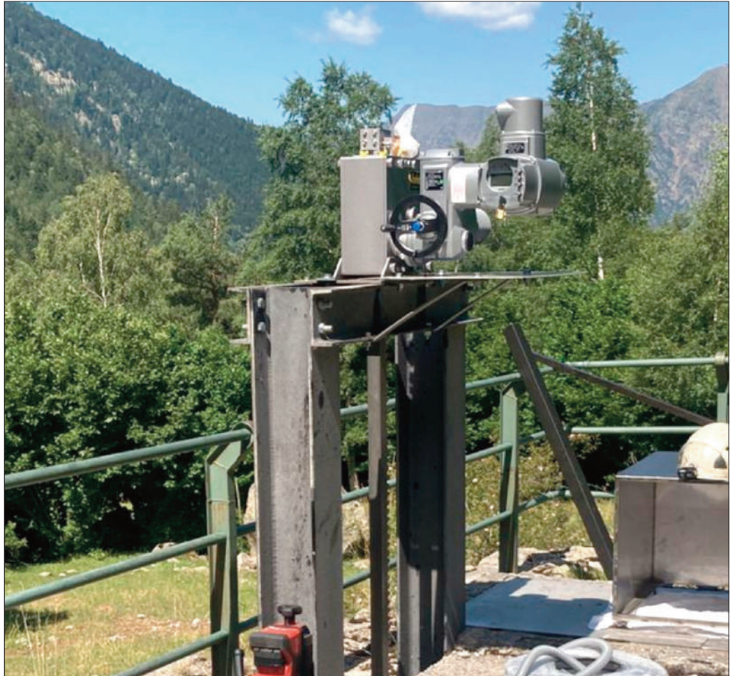
La presa de Ràmio, on s'ha provat el sistema de telecomanda.
